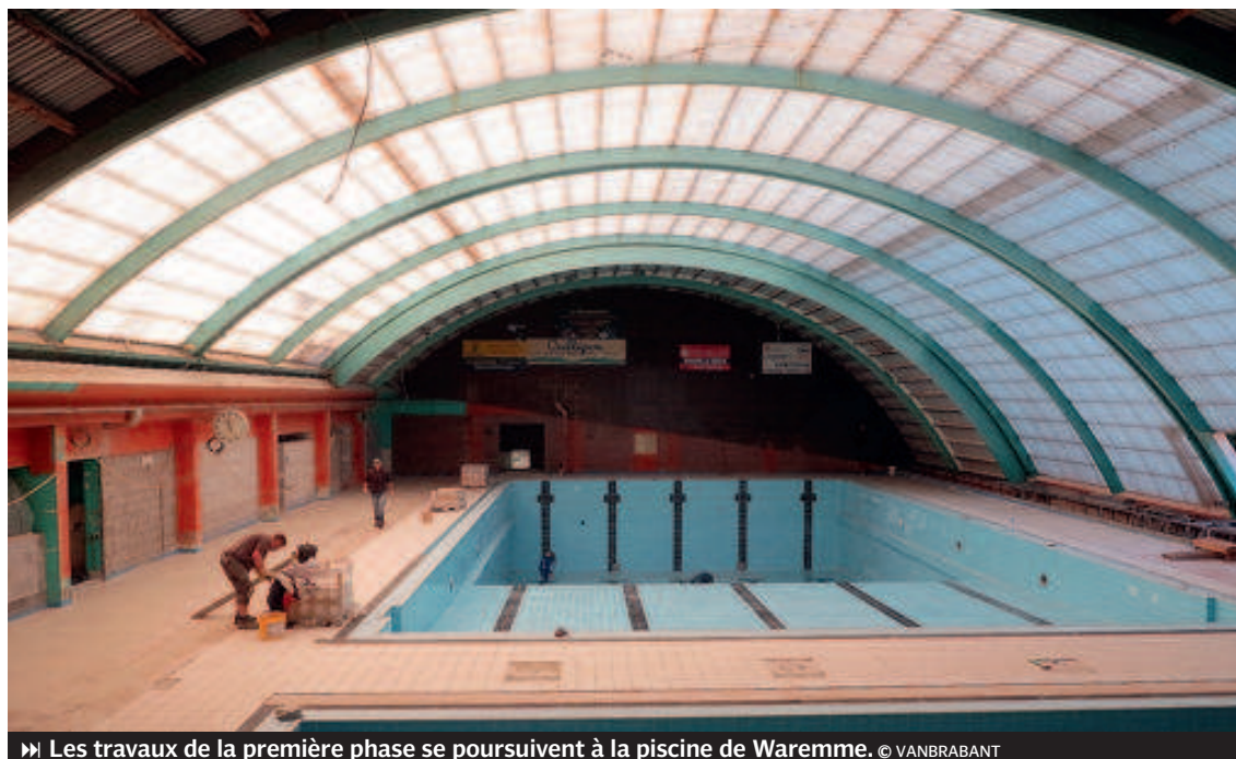
▶ Les travaux de la première phase se poursuivent à la piscine de Waremme. © VANBRABANT
