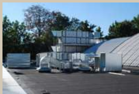
Le nouveau système de ventilation permet de chauffer séparément les vestiaires et la piscine.
