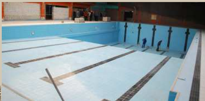
Dans les bassins, les ouvriers donnent un dernier coup de balais. Pour la rénovation de la toiture, un plancher sera mis en place pour les protéger.
